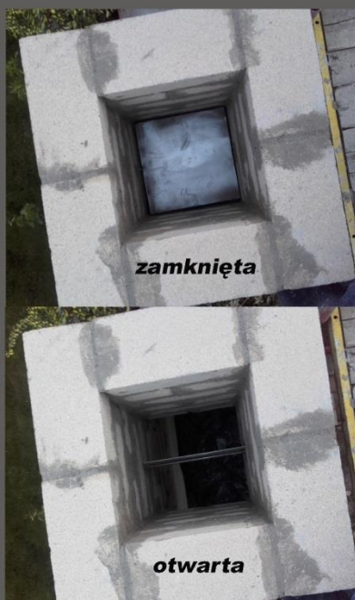
fot. 19. Przepustnica w kominie
